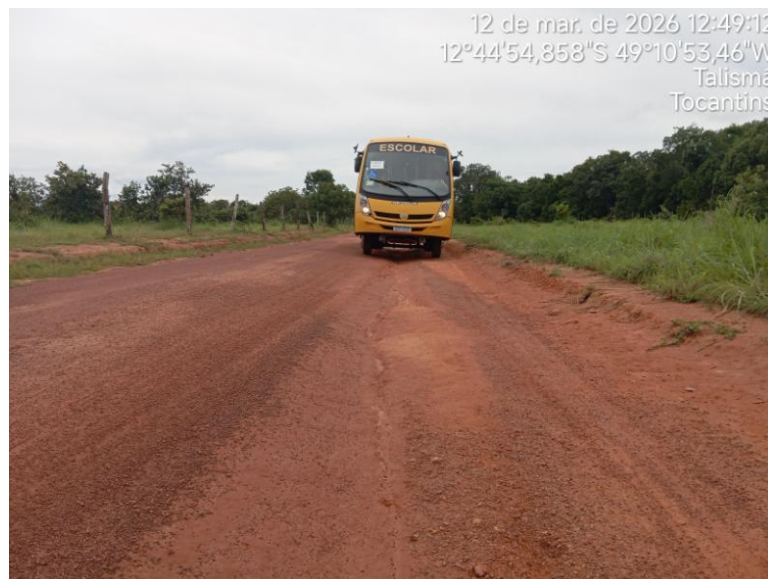
IMAGEM 06: Chuvas intensas - ravinas no centro da pista afetando o transporte escolar. Data: 12/03/2026. Coordenadas Geográfica: Latitude - 12°44'54.858"S e Longitude - 49°10'53.46"W.
